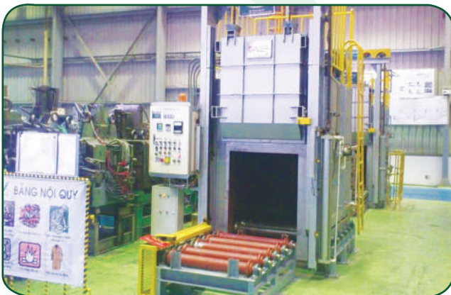
HỆ THỐNG CON LĂN LÔ NHIỆT LUYỆN ROLLER CONVEYOR SYSTEM
