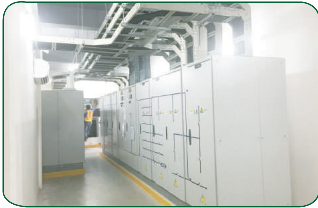
TRẠM BIẾN ÁP / TRANSFORMER
