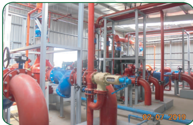
HỆ THỐNG PHÒNG CHÁY CHỮA CHÁY / FIRE FIGHTING SYSTEM
