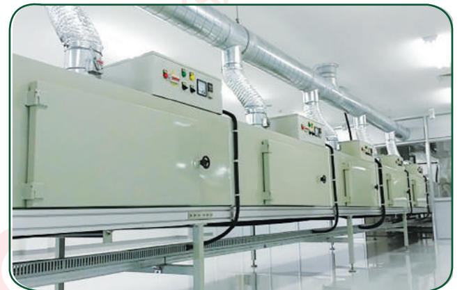
HỆ THỐNG BĂNG TẢI SẤY / DRYING CONVEYOR SYSTEM
