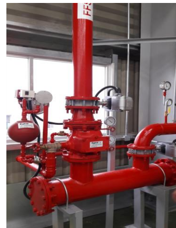
Hệ thống chữa cháy màng ngăn nước/ Drencher system
