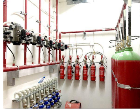
Hệ thống chữa cháy bằng khí Ni- tơ/ Nitrogen (N2) Fire Extinguishing System
