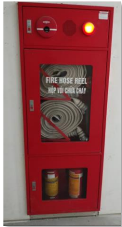
Hệ thống chữa cháy vách tường/ Water Spray System
